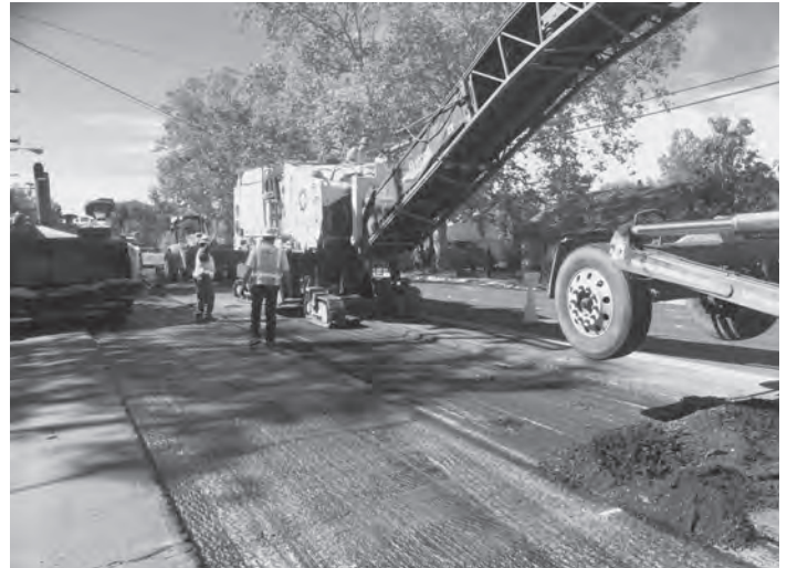
Una cuadrilla de trabajadores labora en una de las muchas mejoras de las calles el año pasado como parte del Proyecto de Reparación de Pavimentos de la Medida Q
